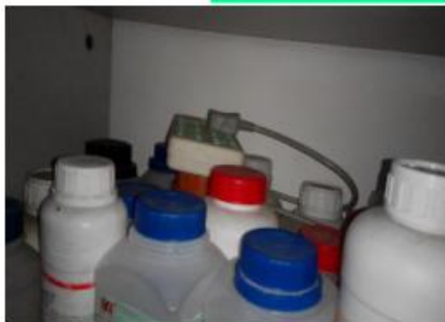
试剂柜中有接线板
