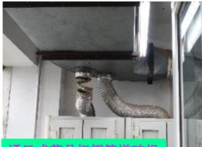
通风式药品柜阀管道破损
